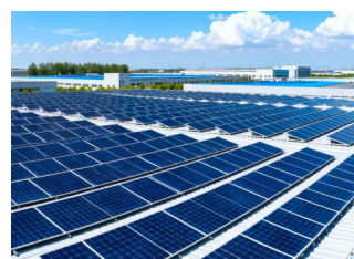
商业屋顶光伏系统
