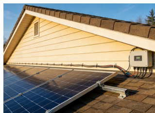
户用屋顶光伏系统
