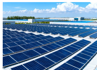
商业屋顶光伏系统
